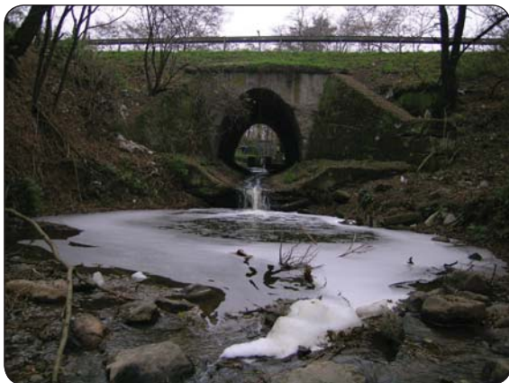
Výtok z odkaliska Poša, potok Kyjov (november 2005)
