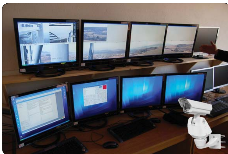
Riadiace centrum a monitorovacia kamera
