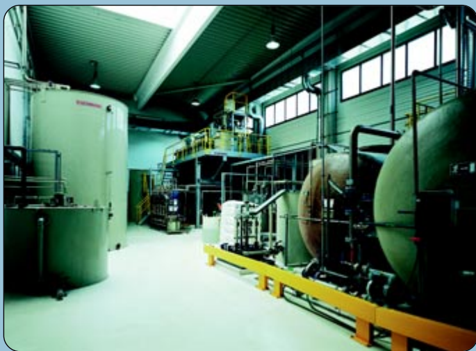
DKTL - linka na kataforézne lakovanie a voskovanie, časť neutralizačná stanica
