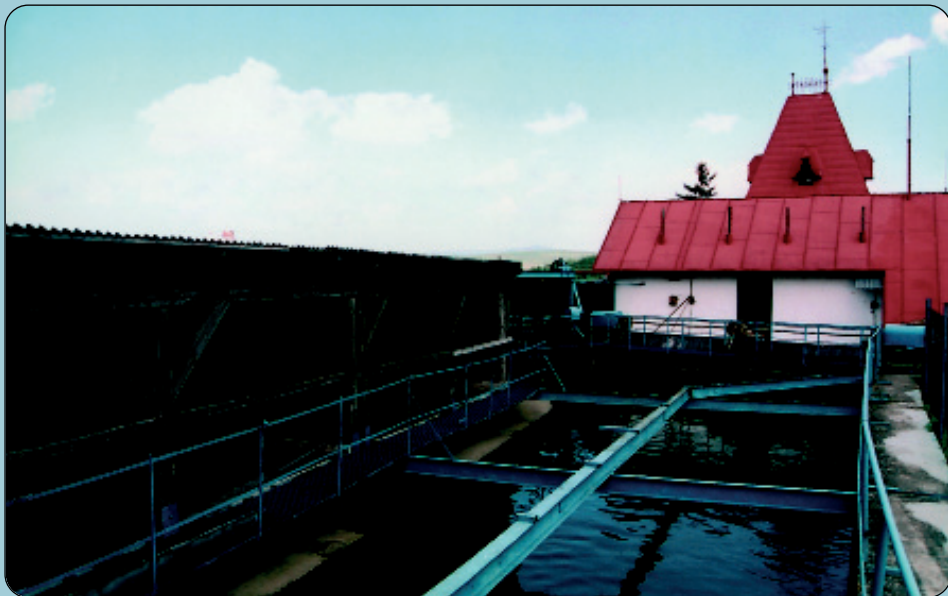
Vodná elektráreň Hunčovce
