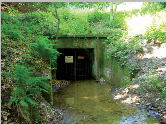
Z Pyritovej štôlne, ktorej vstup je zabezpečený mrežou, vyteká banská voda
